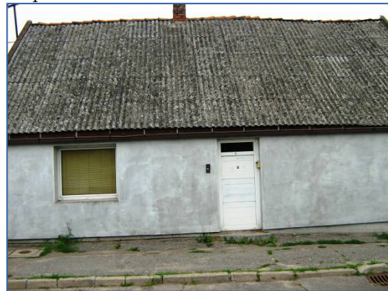
Rys. 7. Pokrycie dachowe ocenione w II stopniu pilności (źródło własne).
